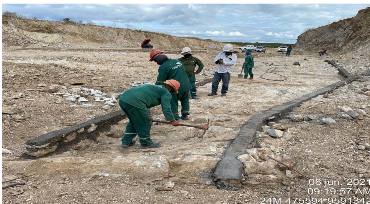
FOTO 98 - Execução de gabarito para início do concreto de regularização (muro lateral direito)
