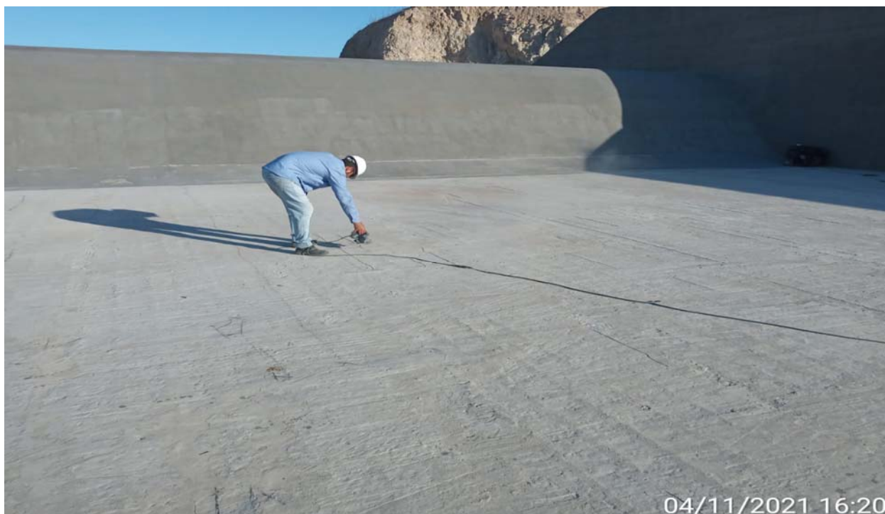
FOTO 165 – Execução de tratamento nas micro fissuras da laje da bacia de dissipação
