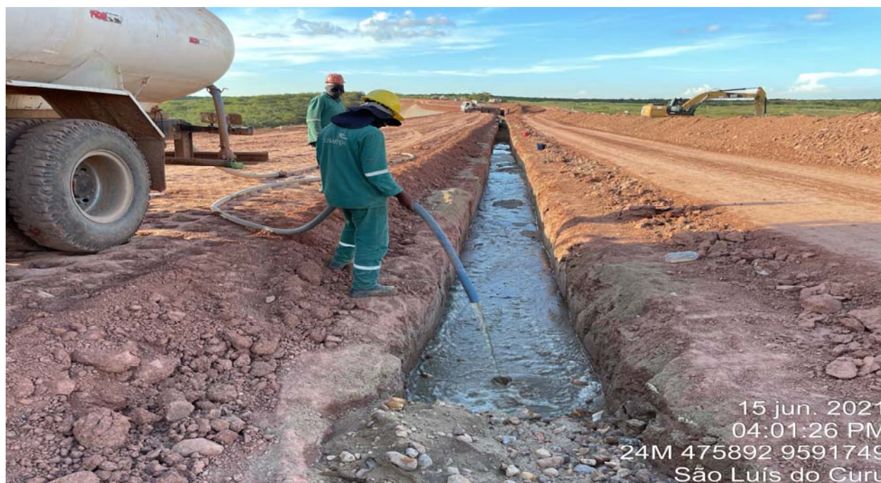
FOTO 102 – Adensamento do filtro vertical (barramento principal)
