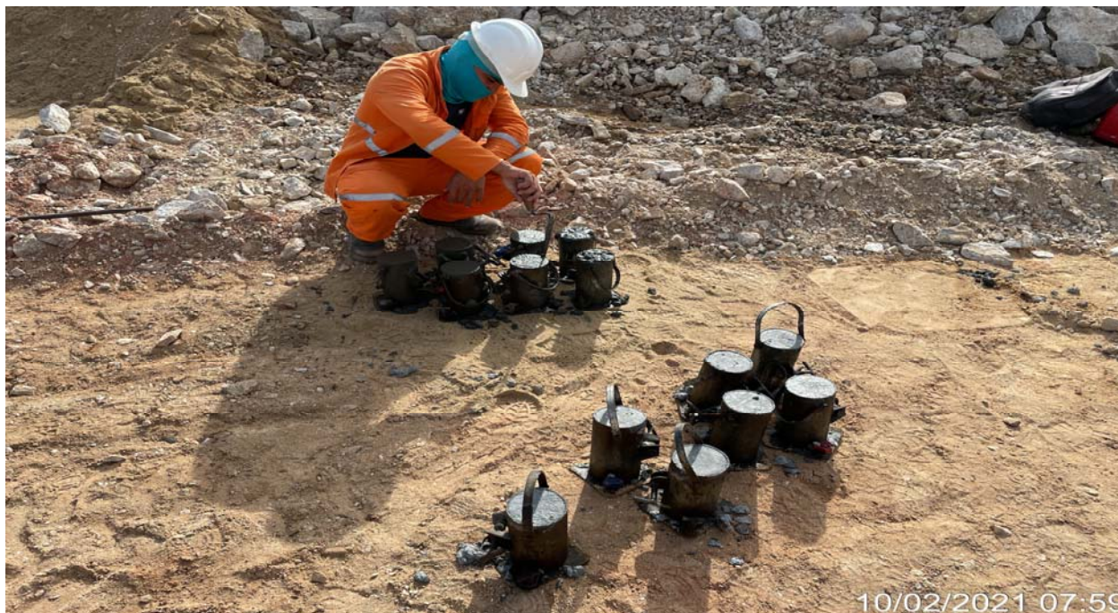
FOTO 53- Execução de ensaio no concreto da tomada d'água (moldagem de corpo de prova)
