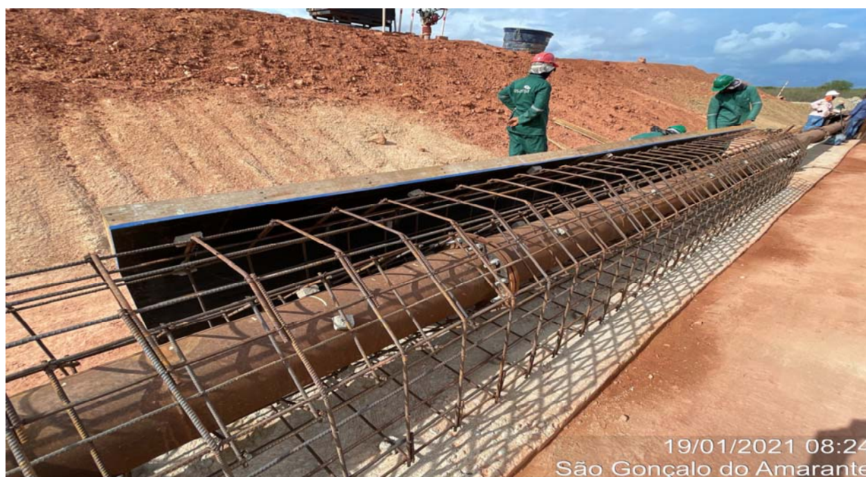
FOTO 40 – Detalhe da armadura e forma para estrutura do envelopamento da tubulação da tomada d'água.
