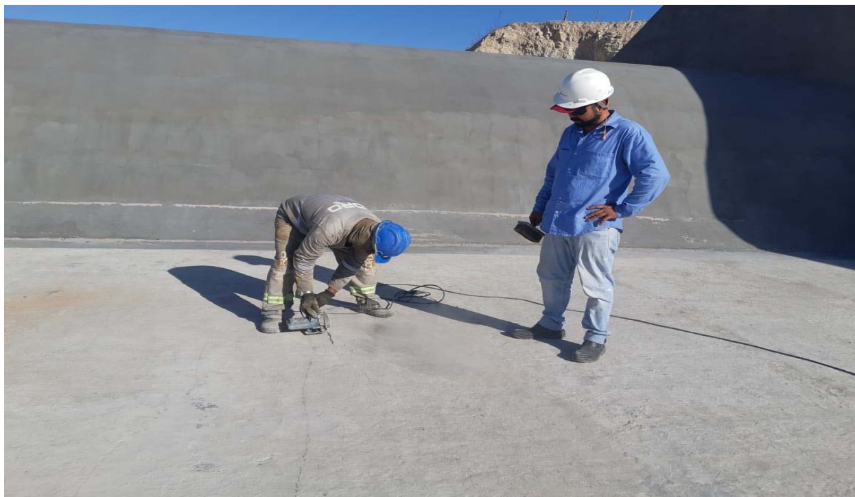
FOTO 163 – Execução de tratamento nas micro fissuras da laje da bacia de dissipação.
