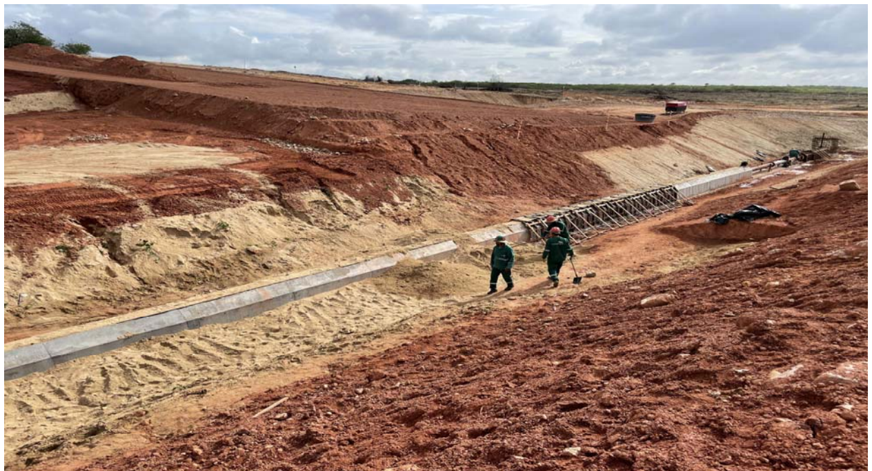
FOTO 60 – Execução do aterro da tomada d'água sobre o filtro horizontal de areia
