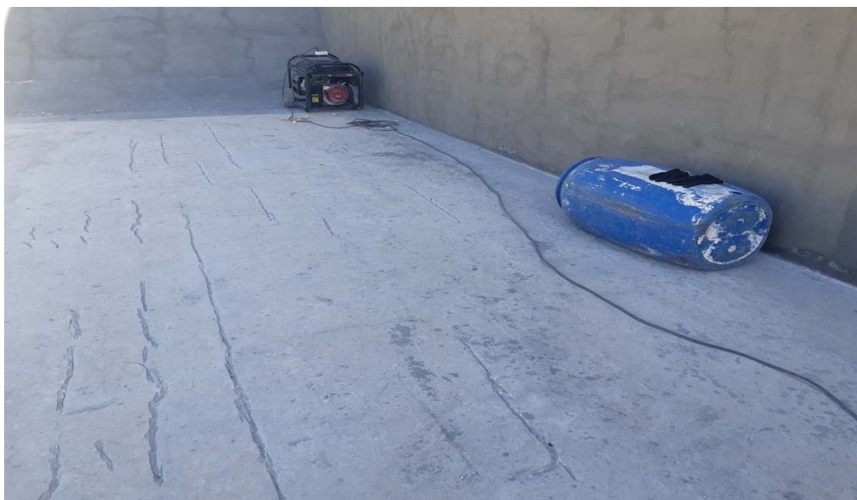
FOTO 164 – Execução de tratamento nas micro fissuras da laje da bacia de dissipação.
